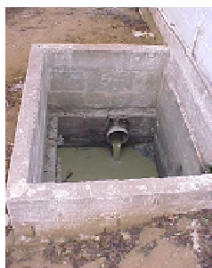
Sistema de esgoto Caixa de distribuição do chorume junto às bacias
