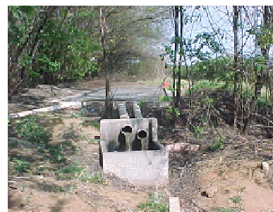
Saída do chorume da caixa de recepção para a canalização que leva à lagoa anaeróbica
