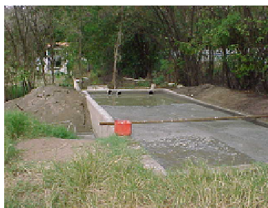
Caixa de recepção de chorume
